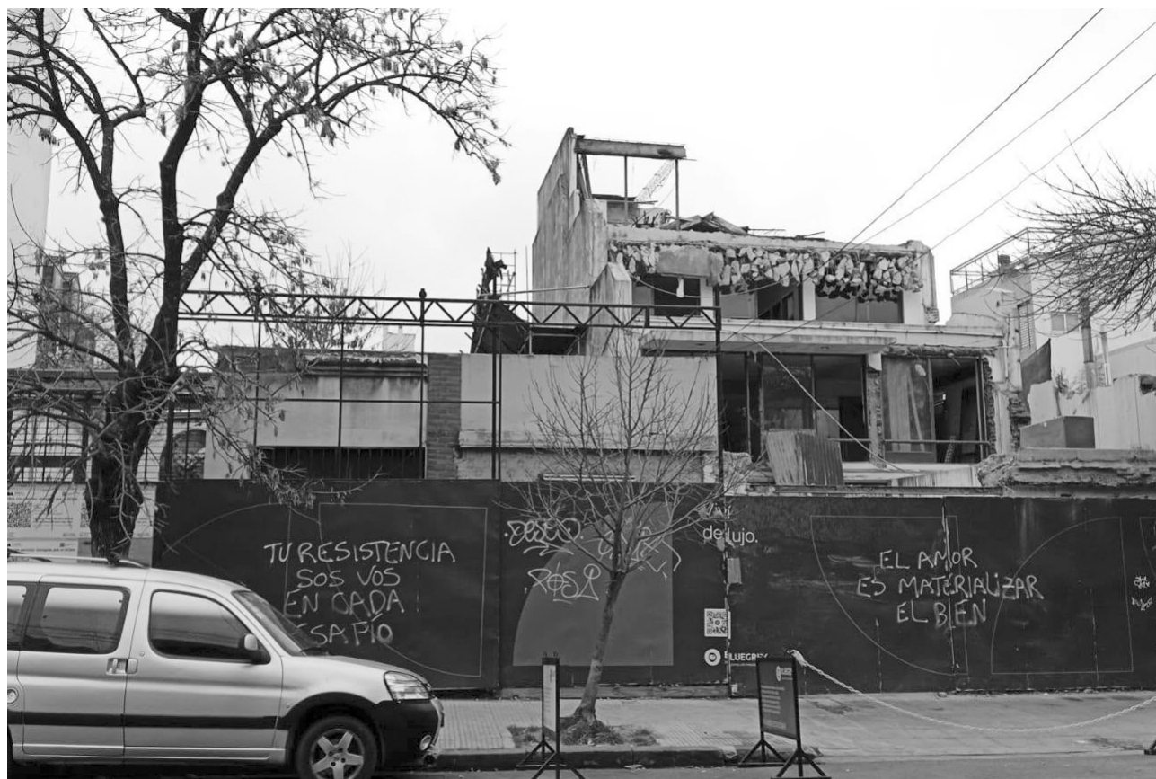
Freire entre Virrey Olaguer y Feliú y Virrey Avilés. Otra demolición en el barrio. En este caso, de la edificación donde durante varios años funcionó una clínica pediátrica. También, algunas propiedades vecinas, por ejemplo, el local comercial en el cual estaba la pizzería “Lily”.
