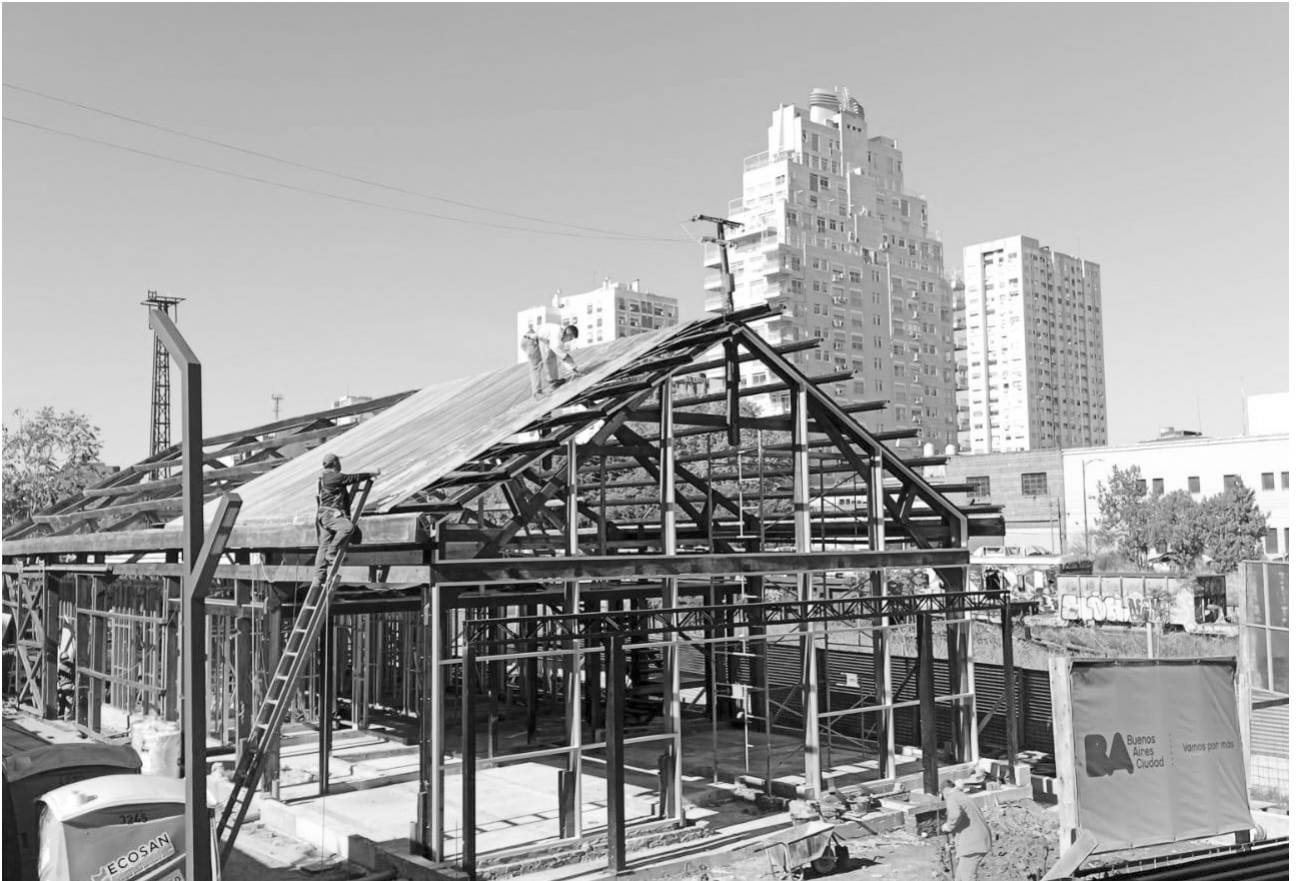
Una vista desde el puente peatonal de Zabala, del futuro Centro de Salud público que está construyendo el Gobierno de la Ciudad en un ex galpón ferroviario. Según dijeron las autoridades porteñas, podría estar terminado en julio.
