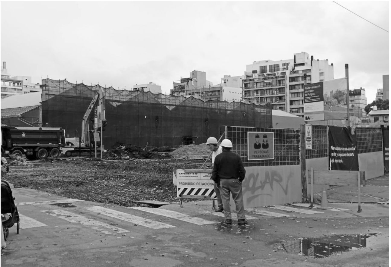
Continúan trabajando en la futura plaza de Concepción Arenal entre Gral. Enrique Martínez y Álvarez Thomas. En la foto, el estado de las obras, con la calle Martínez interrumpida al tránsito vehicular en este sector.
