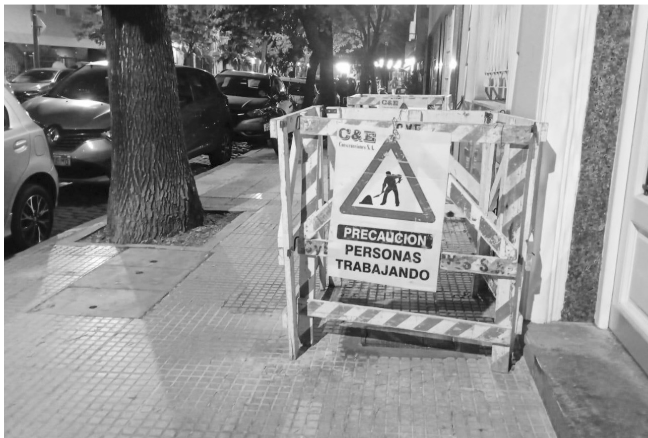
Teodoro García entre Crámer y Conesa. Desde hace unas semanas, numerosos sectores del barrio presentan este aspecto: vallas de madera y un cartel que indica “precaución”. Se trata de obras en las entradas de los edificios realizadas para la empresa Aysa.
